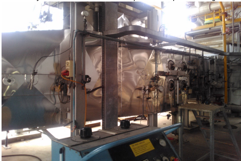
Immagine 1 – Canalizzazione dei fumi esausti in caldaia a recupero dell'impianto di cogenerazione
